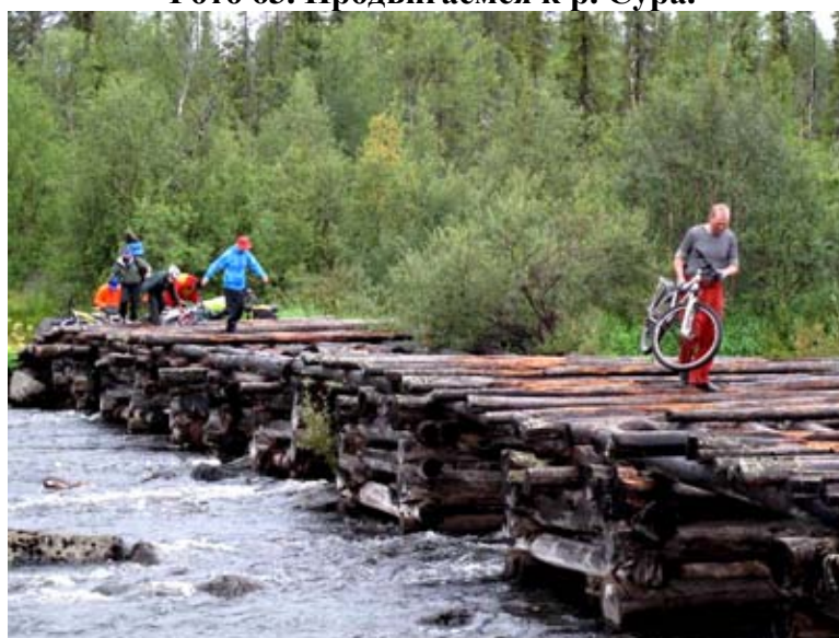
Фото 64. Разрушенный мост через р. Сура.
