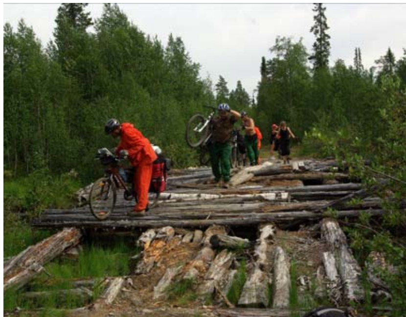
Фото 13. Разрушенный мост через р. Щучья у оз. Мунозеро.
