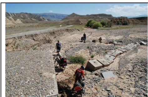
39. Разрушенный мост в пересохшем русле р. Терек
