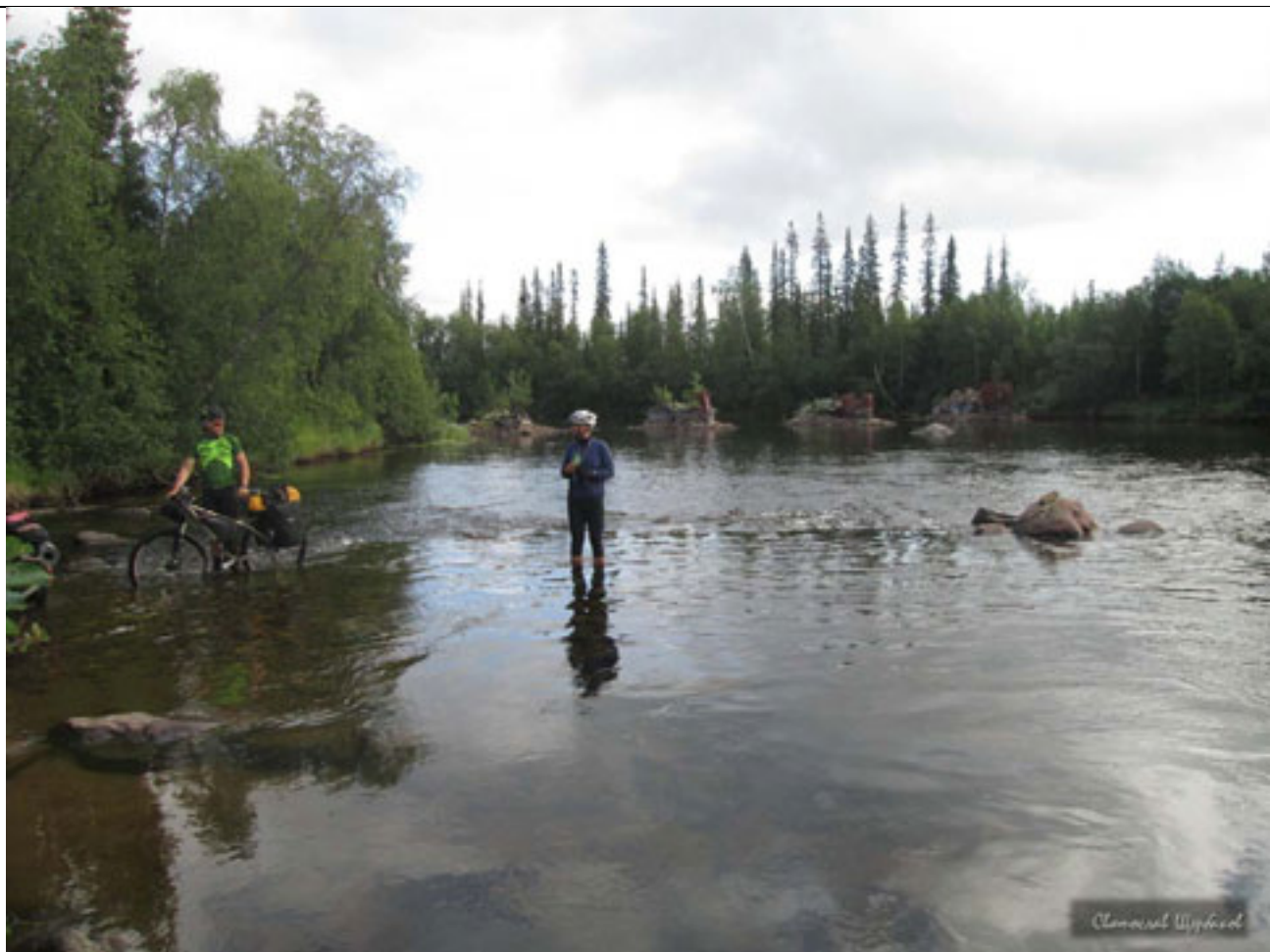
Вид на разрушенные опоры моста с более глубокой половины брода через р. Конья
