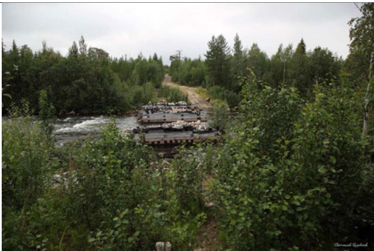
Вид на р.Печа с опоры разрушенного моста
