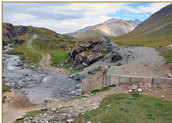
Развалившийся мост через безымянную речушку
