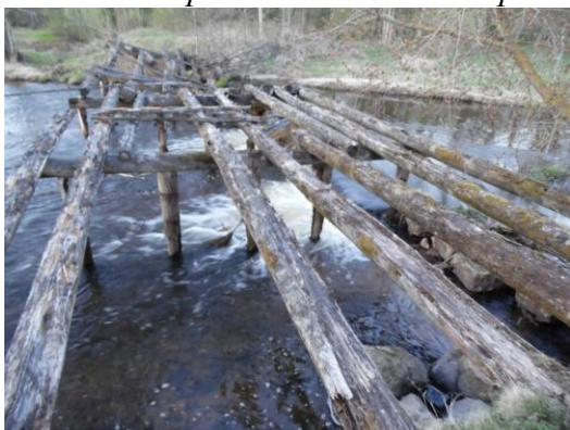
Сгоревший мост через р. Сула в Новополье День 2: Новополье – р. Ислачъ
