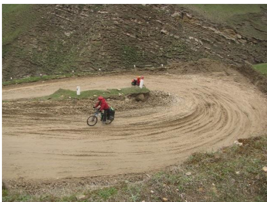
28.Грунт разбитый (подъем на перевал)
