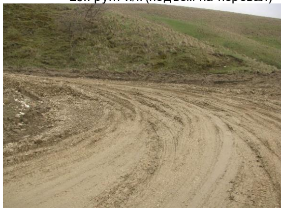
27.Грунт разбитый (подъем на перевал)
