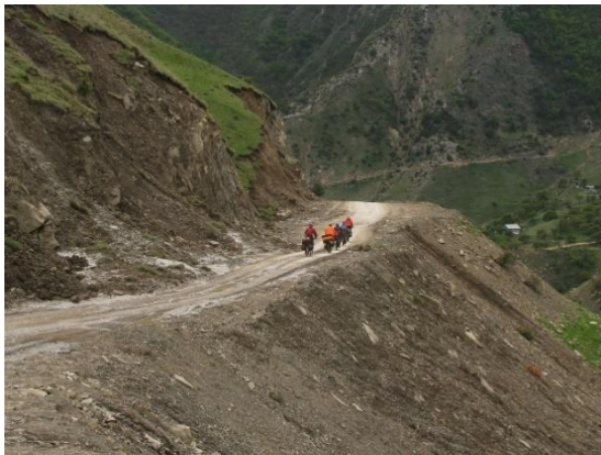
39.Грунт х/к (размытый участок дороги)
