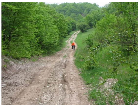
9. Грунт разбитый (подъем на хр. Надыр Бек)
