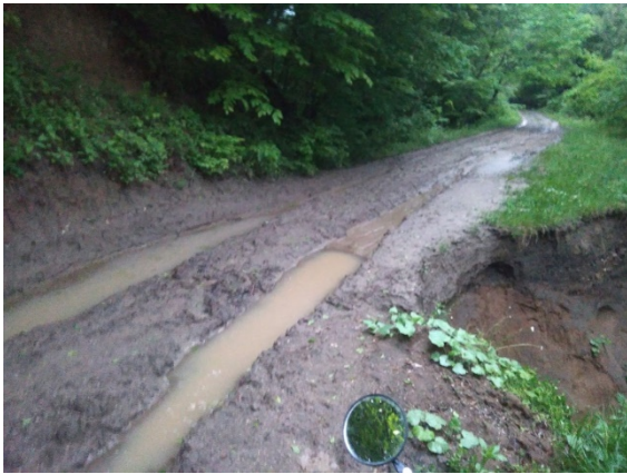
9. Размыв дороги, справа глубокий обрыв
