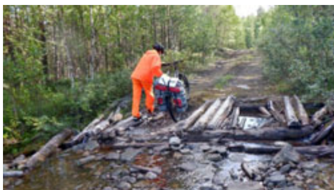
21.ТП, разрушенный настил
