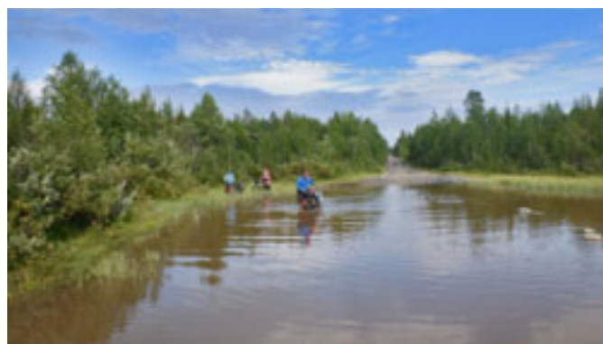
10. Грунт разбитый с ТП, мокрый
