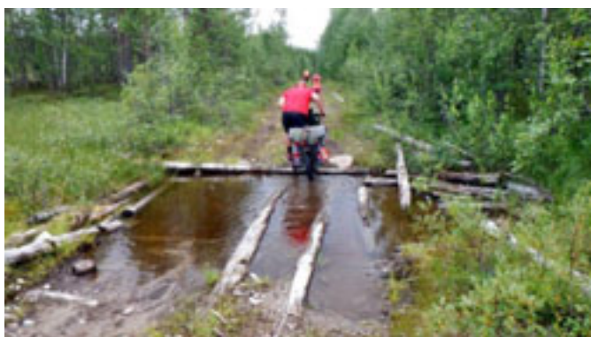
31.ТП, разрушенный настил
