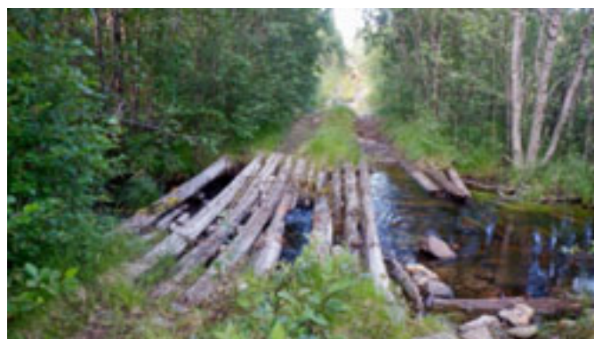
32.ТП, разрушенный мост
