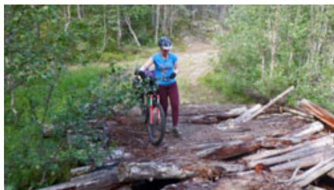
10.ЛП, разрушенный мост
