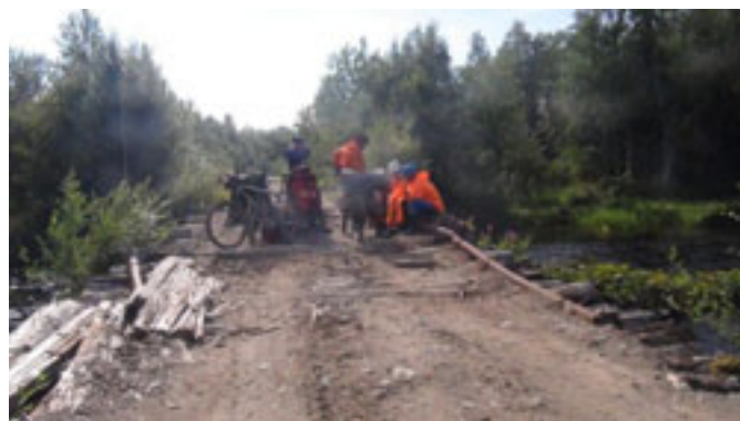
6. Мост р. Кица, грунт разбитый
