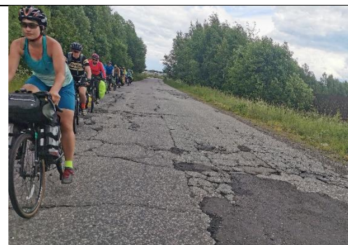
Фото 110. Участок дороги с заплатками
