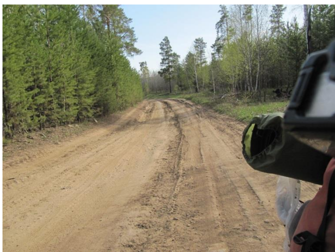
5.Грунт, дорога разбитая, сухая
