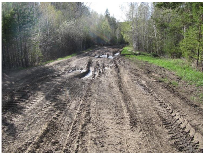
8. Грунт, дорога разбитая, сухая
